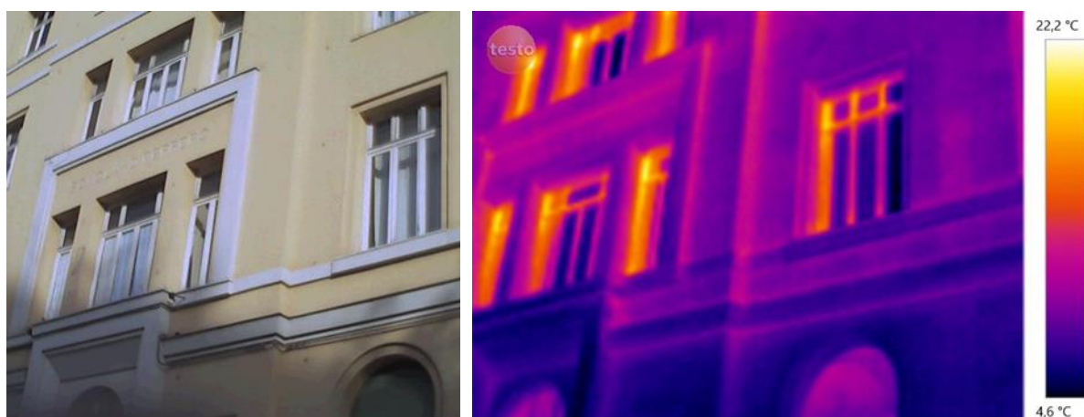
Figura 4.4 – Rilievo termografico serramenti
