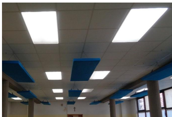
Figura 4.15 - Particolare dei corpi illuminanti ubicati nella mensa
