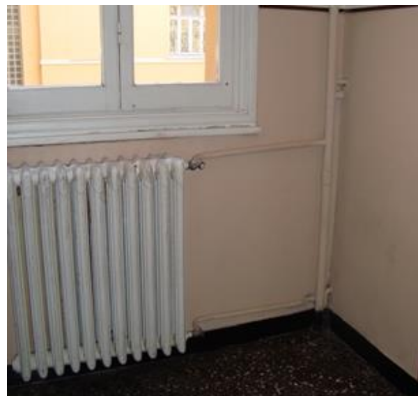
Figura 4.6 - Particolare radiatori su parete esterna
