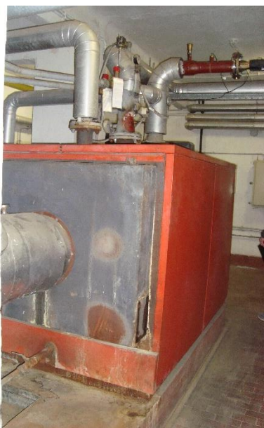
Figura 4.11 - Particolare generatore di calore
