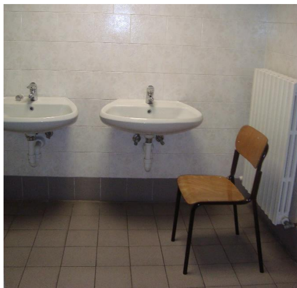
Figura 4.5 – Particolare radiatore su parete interna
