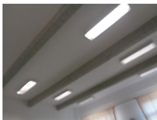
Figura 4.14 - Particolare corpi illuminanti aule
